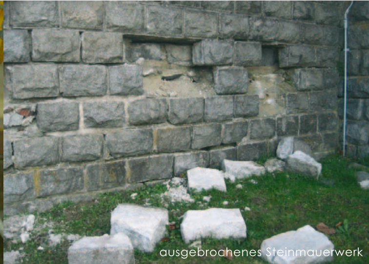
durch Nässe zerstörter Betonbalken
